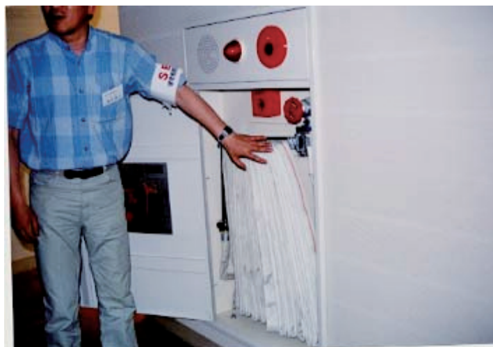
写真1 阪神・淡路大震災時に使用された屋内消火栓
