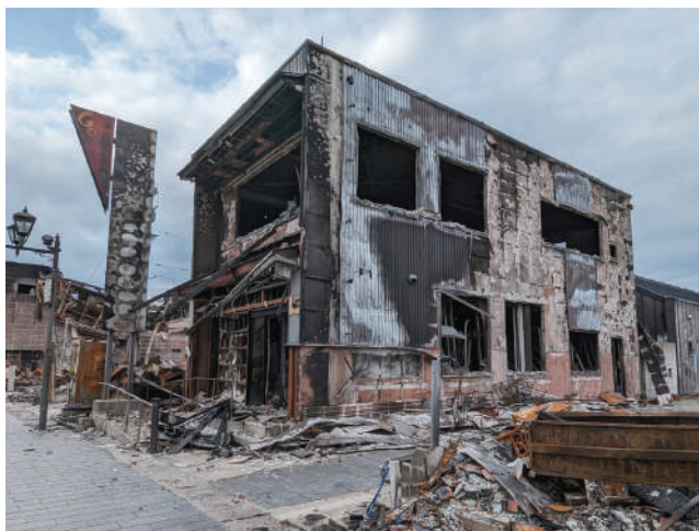
写真：輪島市朝市通り周辺の地震火災により焼失した永井豪記念館 (2024年2月15日撮影)
