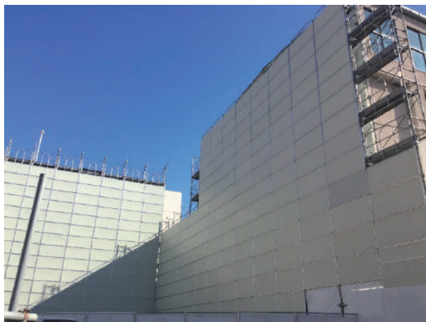
【写真2】 工事中防音パネル施工例 (株キョーワ ホームページより)
