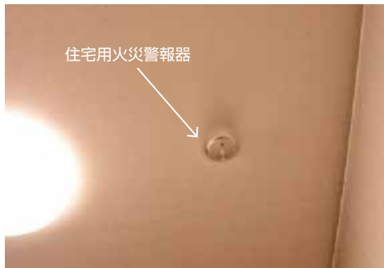
洋室の住宅用火災警報器（煙感応式）の状況
