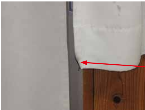
カーテン焼損状況
