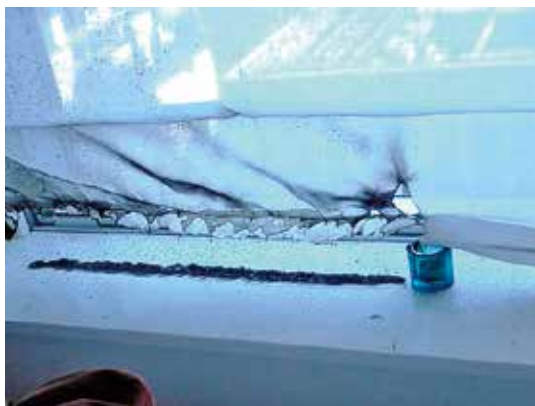
延焼を防いだカーテンの焼損状況
