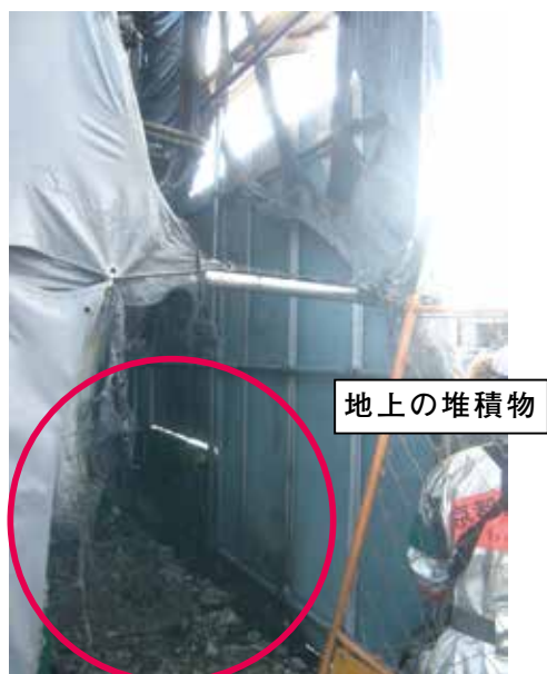
写真4 地上付近の防災シートの焼失状況
