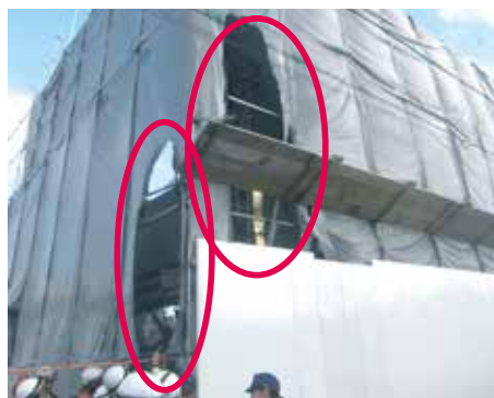
写真1 工事用防災シート2枚が溶融した部分
