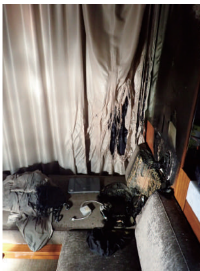
カーテンの焼損状況
