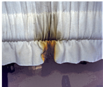
⑤の下部が一部焼損したパーティション (防災カーテン)
