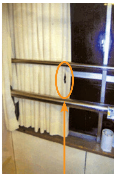
②の一部焼損した防災カーテン（右側が焼損部分）
