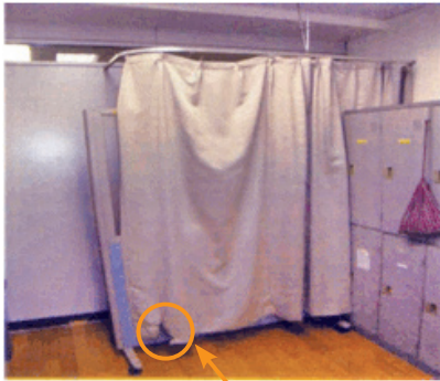
①の一部焼損した防災カーテン（左下が焼損部分）
