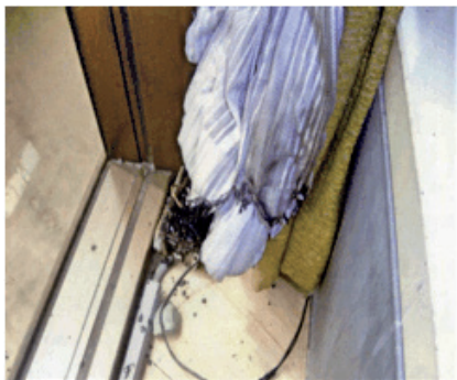
④の下部が一部焼損した防災カーテン
