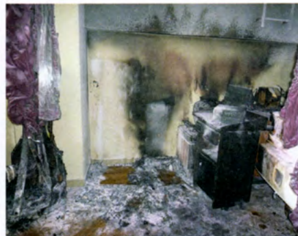
焼失した段ボール・木製品と焼け縮んだ中袖幕
